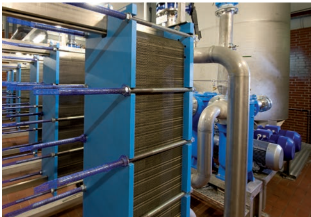
Wärmetauscher zur Prozesswassertrennung.
